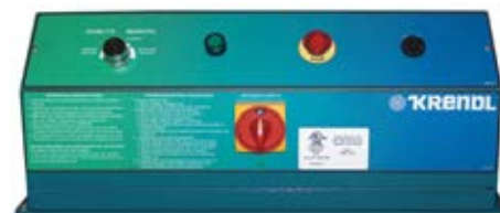
Panneau de commande électrique
